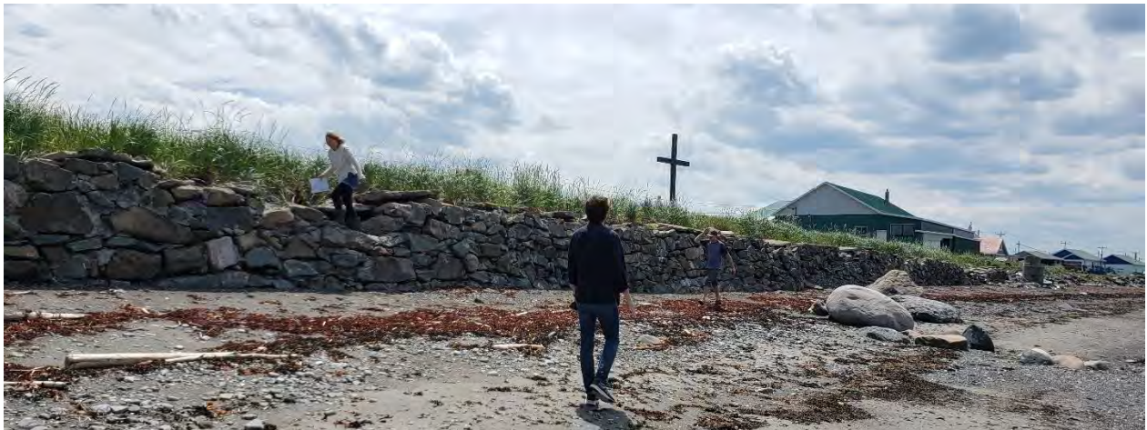
Figure 6. Mur de protection endommagé du cimetière de Petit-Matane (Matane) Source : Auteure, 2021
