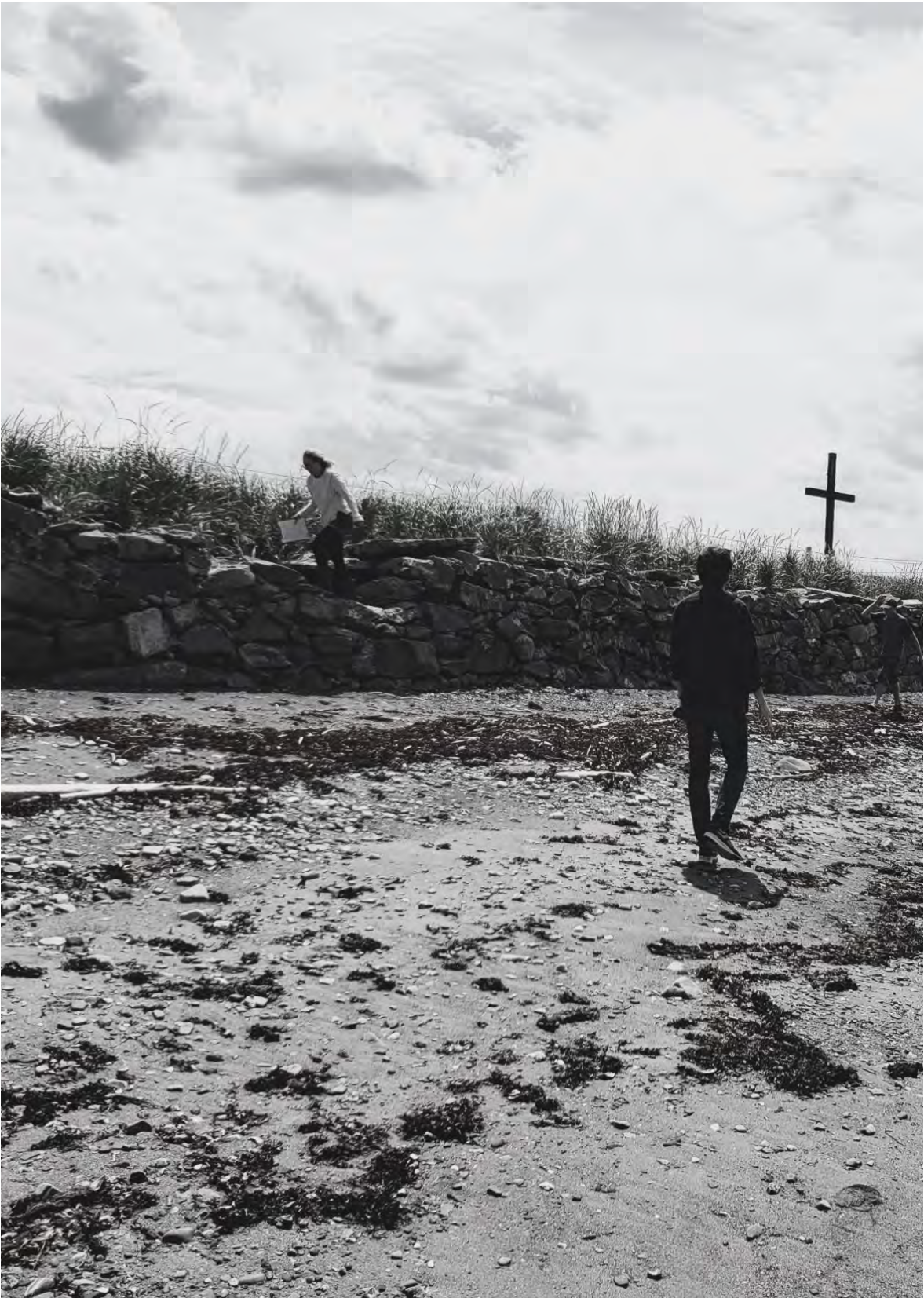
Figure 21. Mur de protection endommagé au cimetière de Petit-Matane, en Matanie (Source : Auteure, 2021)
