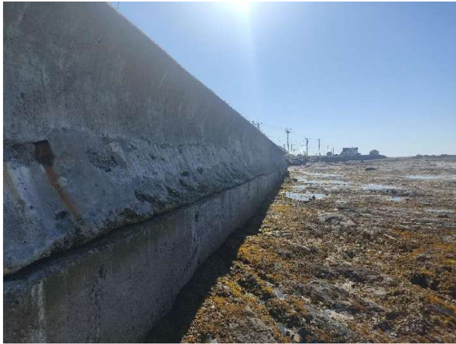
Image 3 : Muret de protection à Sainte-Félicité, prise le 8 août 2022
